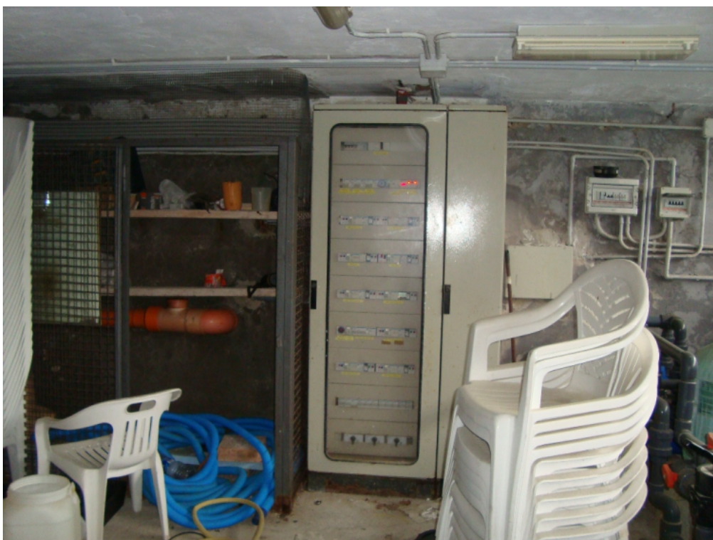
Immagine 23 – quadro elettrico
