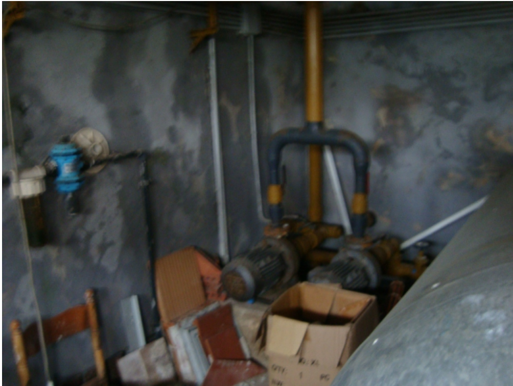
Immagine 24 – impianto di pompaggio
